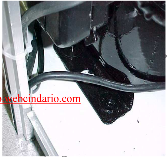
Detalle de la sujeción del motor y los cables.
